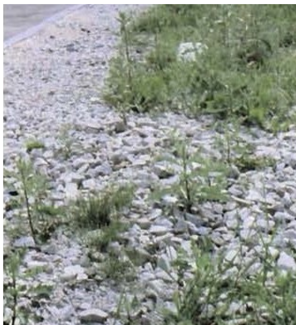
Bild 12. Det är vanligt med roto­gräs i underbyggnaden vilka måste åtgärdas före utläggning av ytskikt.
