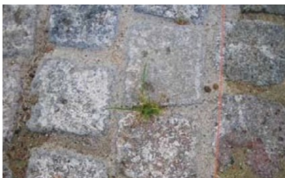
Bild 5. För smal fog vilket har resulterat i ogräsuppslag i trafikerad yta.
