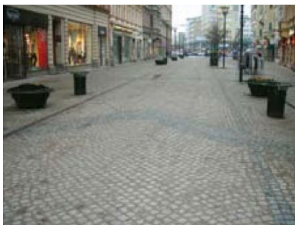
Bild 18. Yta efter åtgärd.
